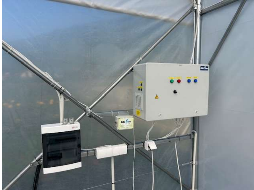
Slika 2: Prikaz Ormara u kome je smeštena automatika za kontrolu plastenika.
